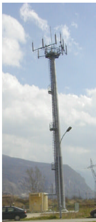
Foto 3. Installazione di tipo raw-land
