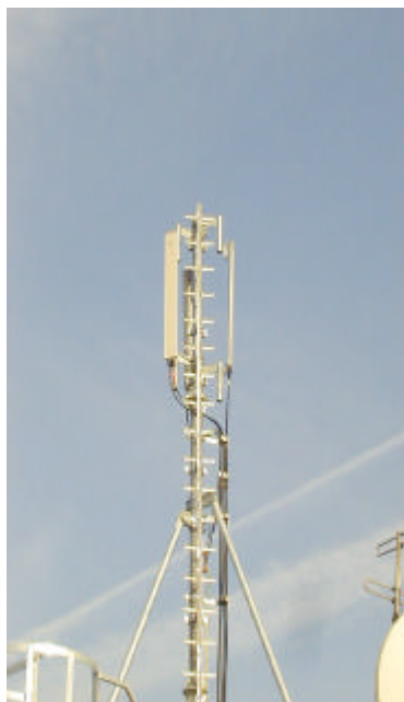
Foto 2. Installazione Urbana su monopalo
